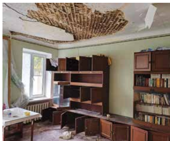
Отсутствие ремонта кровли многоквартирного дома № 9 по ул. Борьбы г. Волгоград после пожара
