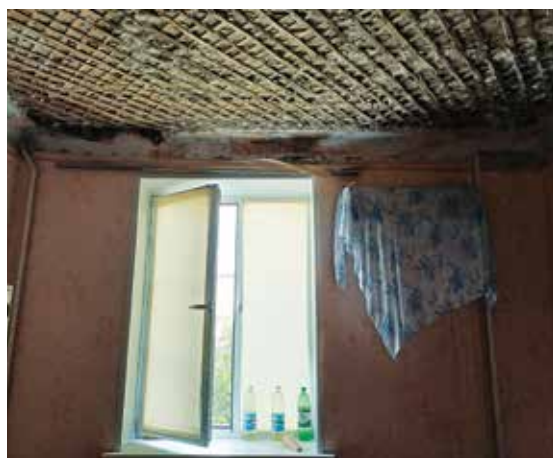
Сгоревшая кровля многоквартирного дома № 9 по ул. Борьбы г. Волгоград
